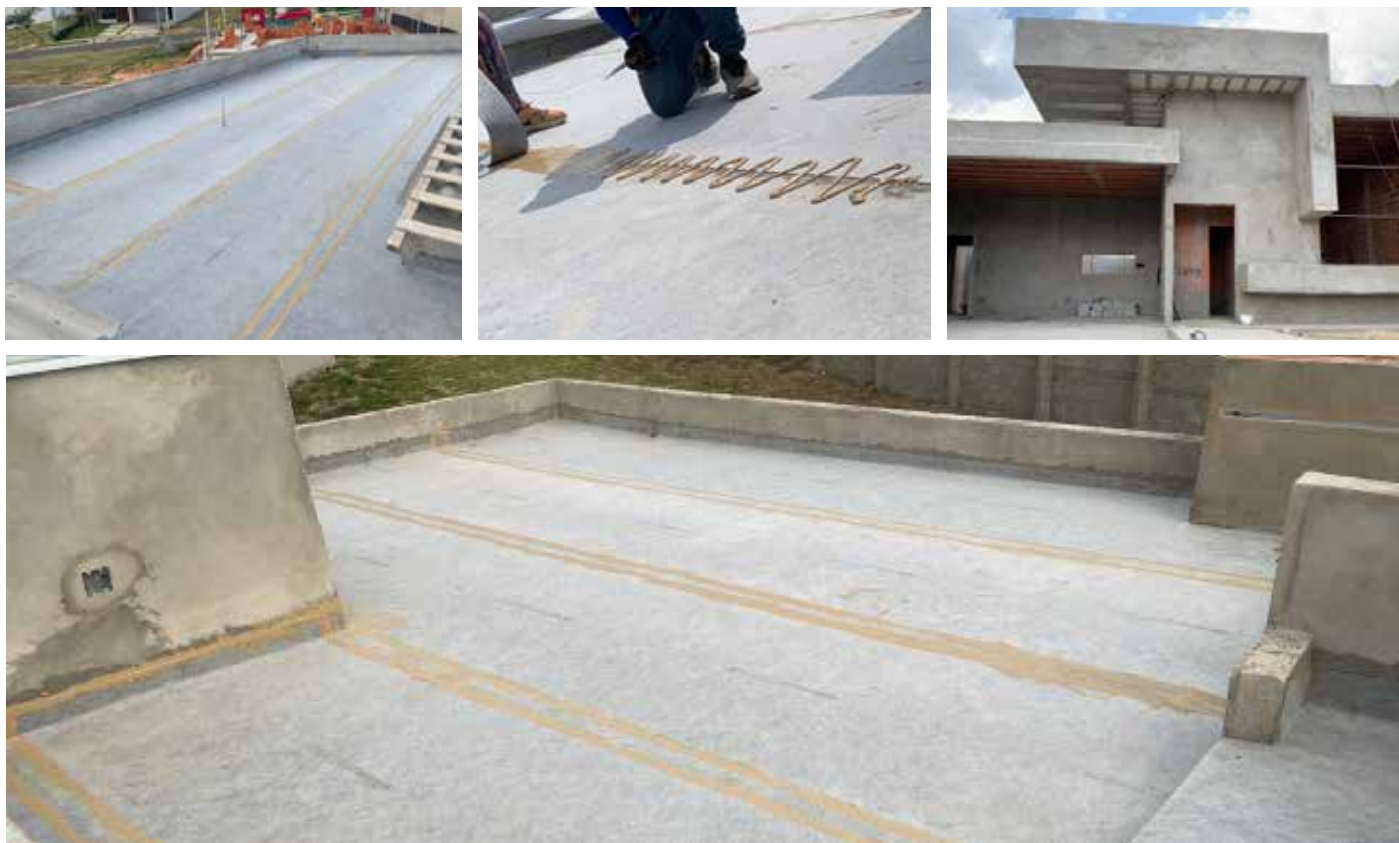
Impermeabilização de 2500 m 2 com ECODRY120 em villas de luxo. Estado de São Paulo. Brasil.
