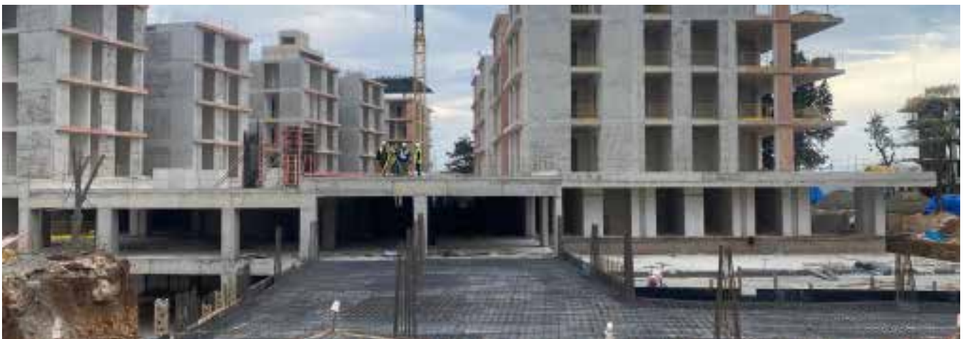
RESIDENCIAL VESEN. 55.000 m 2 DRY40 e DRY50 en interiores. DRY80 en coberturas, terraços e zonas comunes exteriores. Estambul. Turquía.
